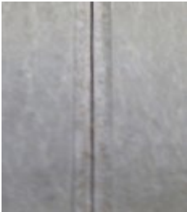
Ranurado no lo suficientemente profundo
